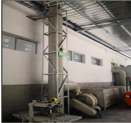
排气筒及标识牌、采样口
