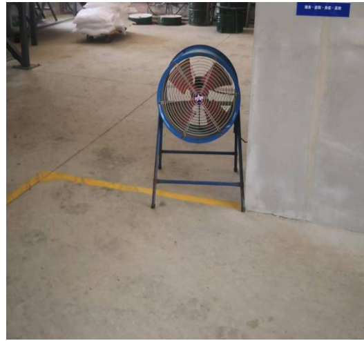
生产车间通风装置
